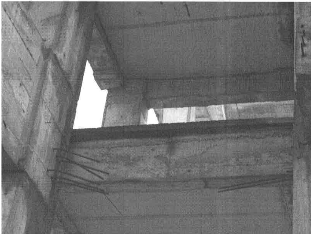
DETALIU INTERIOR CORP A – GRINDĂ LONGITUDINALĂ NEEXECUTATĂ
